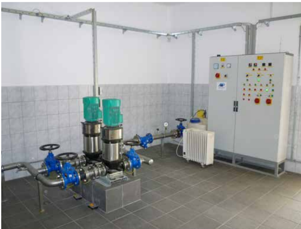
Lecserélt szivattyúk és felújított vezérlés
